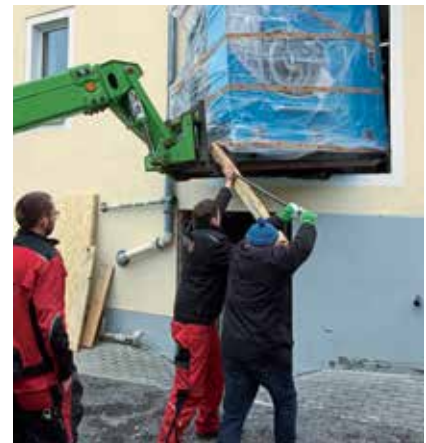
Ein aufregender Moment: Mittels Hubtechnik wurde die neue Reinigungsmaschine Millimeter für Millimeter durch die Fensteröffnung an ihren Platz gehievt.
